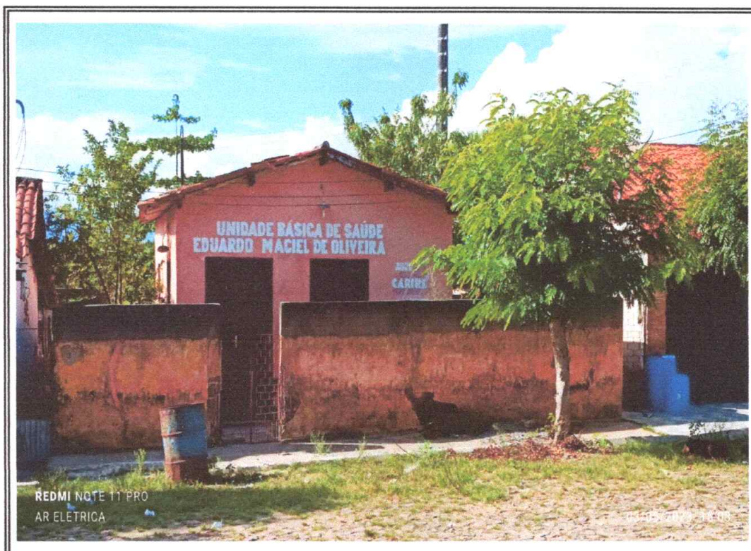
Foto 18- Local deverá receber novo revestimento e pintura
