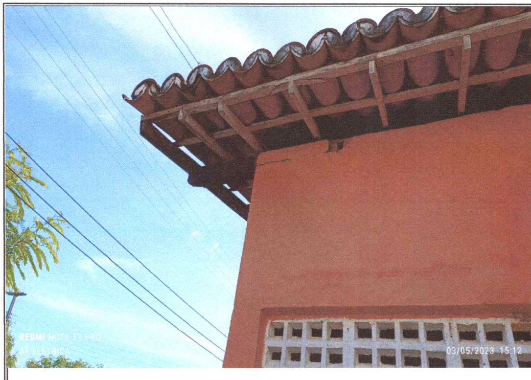
Foto 02- Vista do telhado seladas e defeituosas
