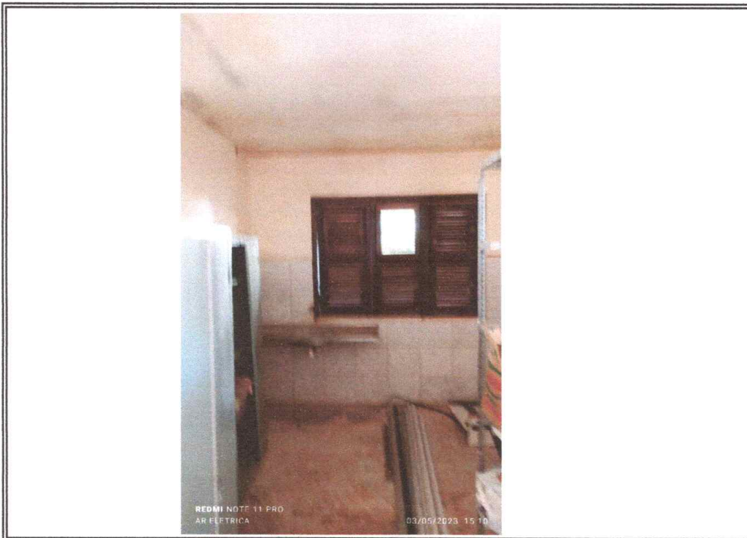
Foto 11 - Vista do local que deveria receber reforço estrutural e novo revestimento
