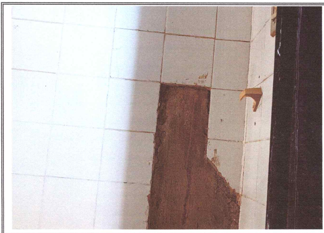
Foto 12- Vista do local que deverão ser recuperados
