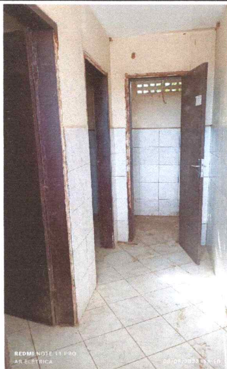
Foto 10-Local deverá ser substituida as portas
