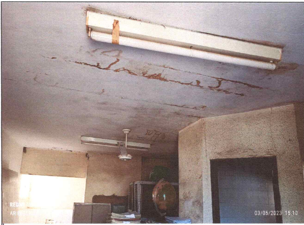
Foto 16- Vista do local que deverá ser recuperado as instalacoes eletricas
