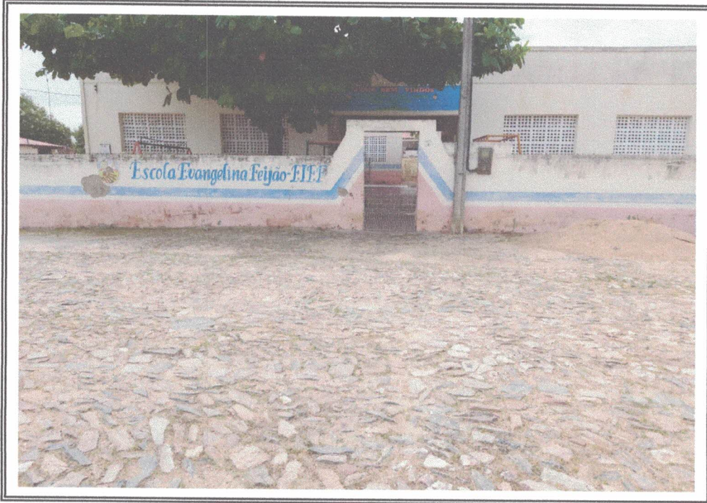
Foto 01 - Fachada da escola danificada
