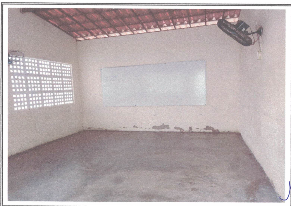
Foto 04 - Paredes com reboco danificado
