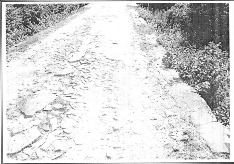
Foto 01 - Pasagem molhada danificada.
