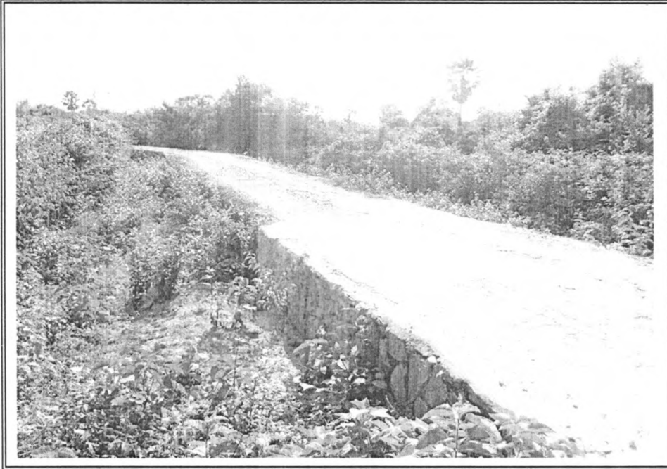
Foto 03 - Local do danificado.
