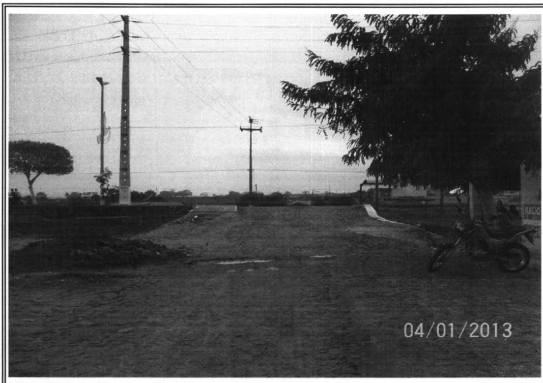
Foto 03 - Local do sangradouro do Polo de lazer a ser construido a passagem molhada.
