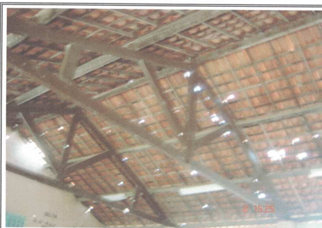
Foto 02- Telhado precisando de retelhamento.
