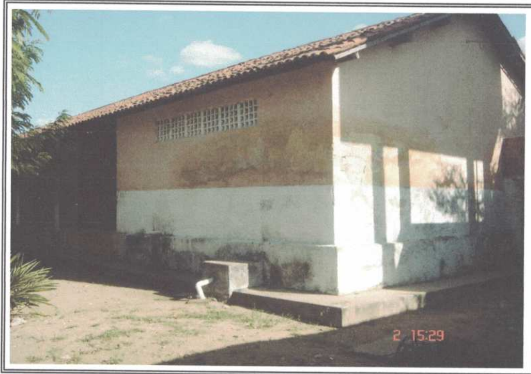
Foto 01 - Vista da pintura danificada.
