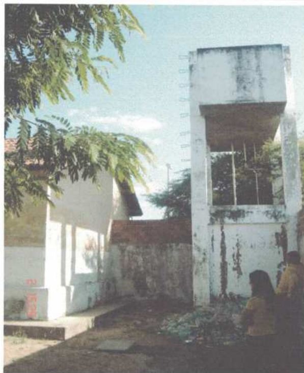
Foto 05 - Caixa D'água com infiltração.
