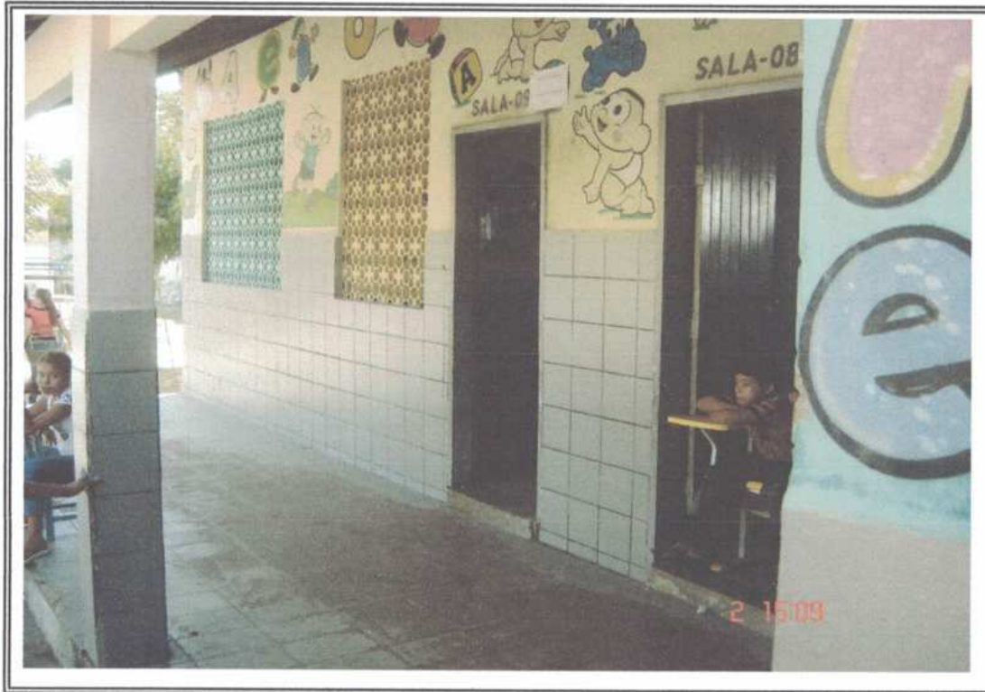
Foto 07 - Vista do piso da circulação danificado.
