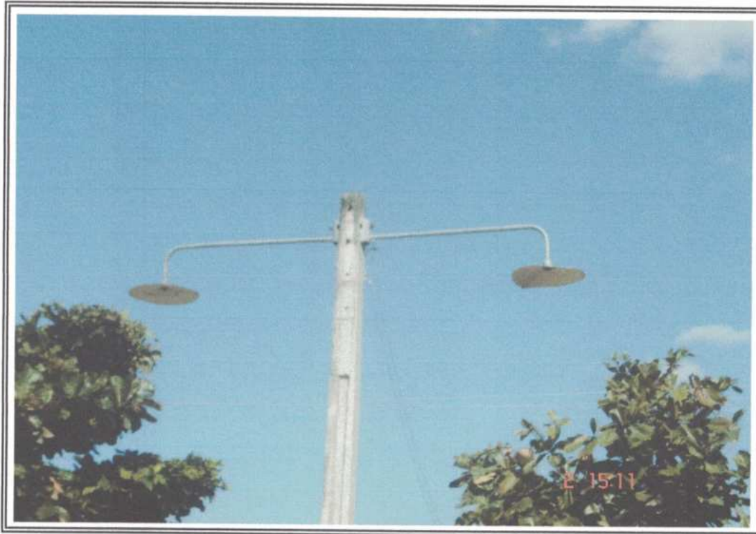
Foto 03 - Instalação elétrica com problema.
