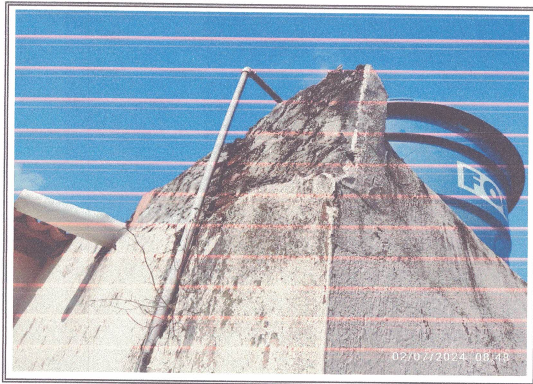
Foto 07 - Caixa dagua danificado
