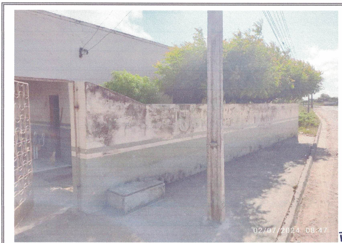
Foto 12- Vista da pintura danificada
