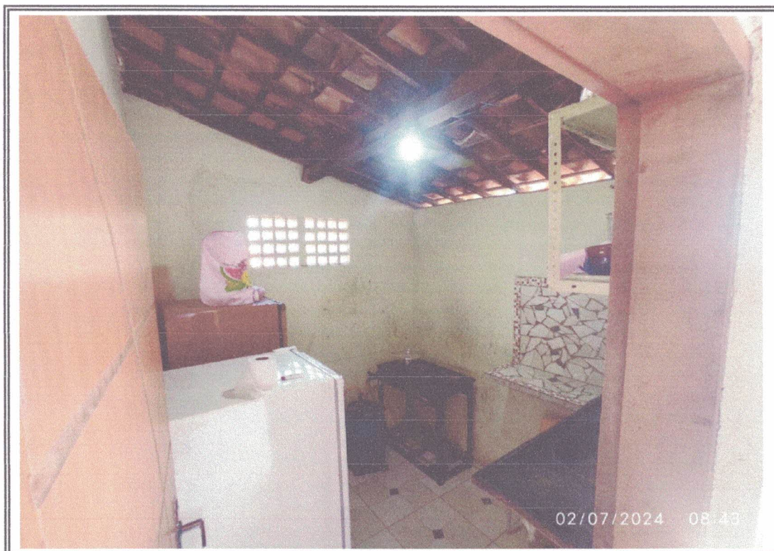
Foto 10 - Vista das porta com defeito
