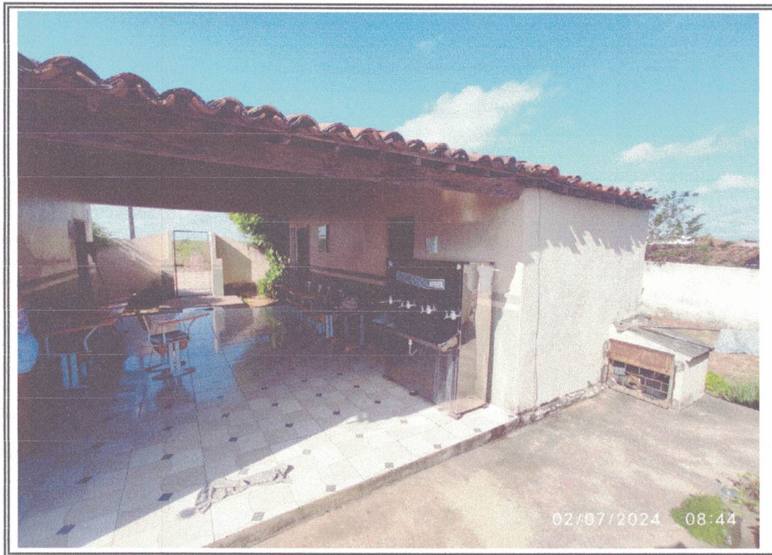
Foto 05 - Vista pintura danificada
