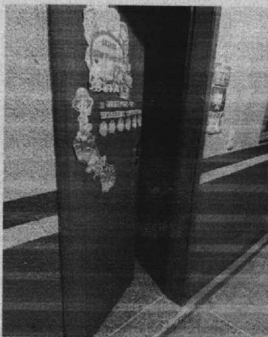
Foto 04-Vista porta com defeito
