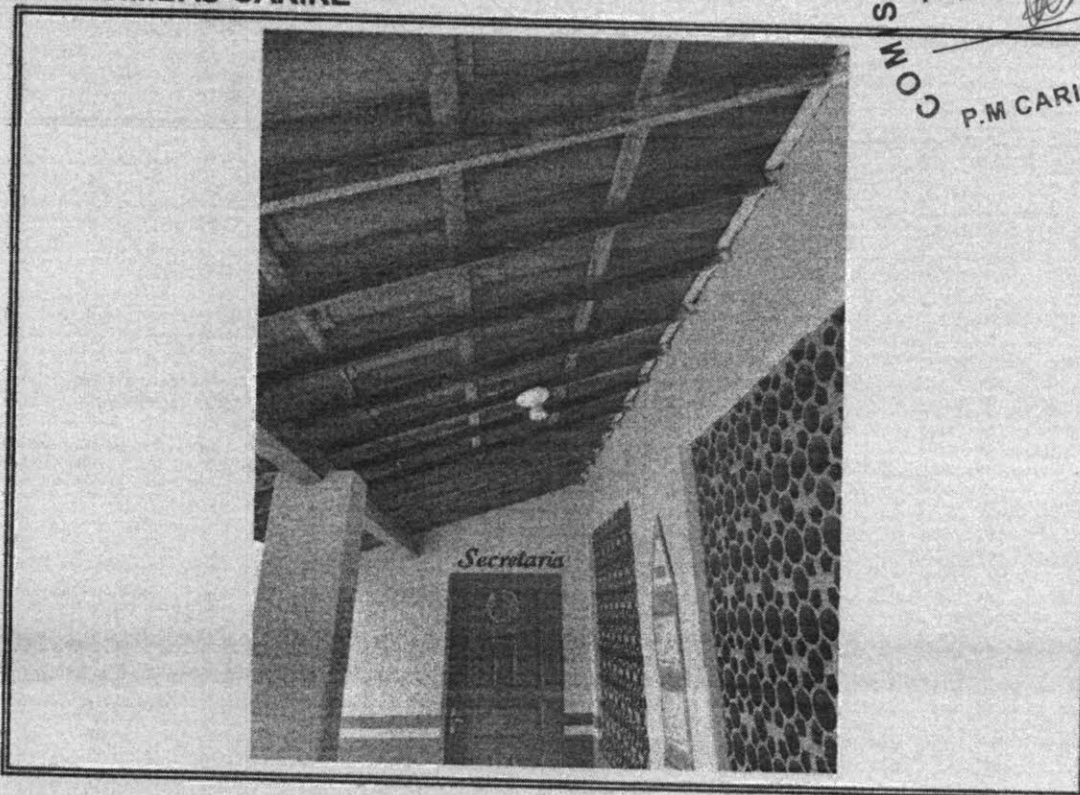
Foto 09 - Vista salas com instalacao danificada
