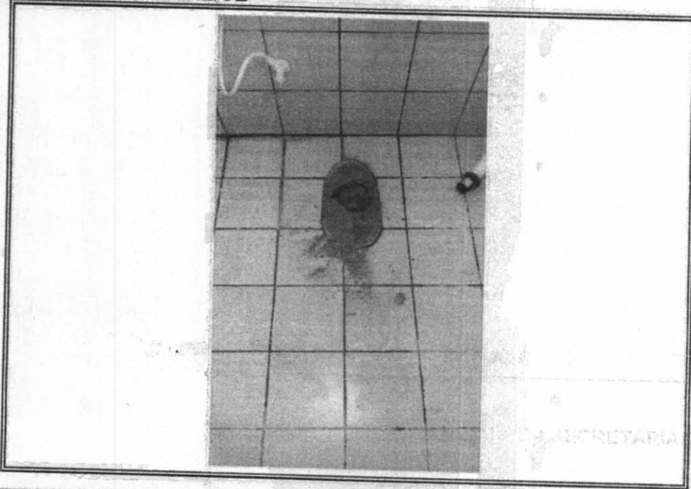
Foto 15 - WC danificado - JURE
