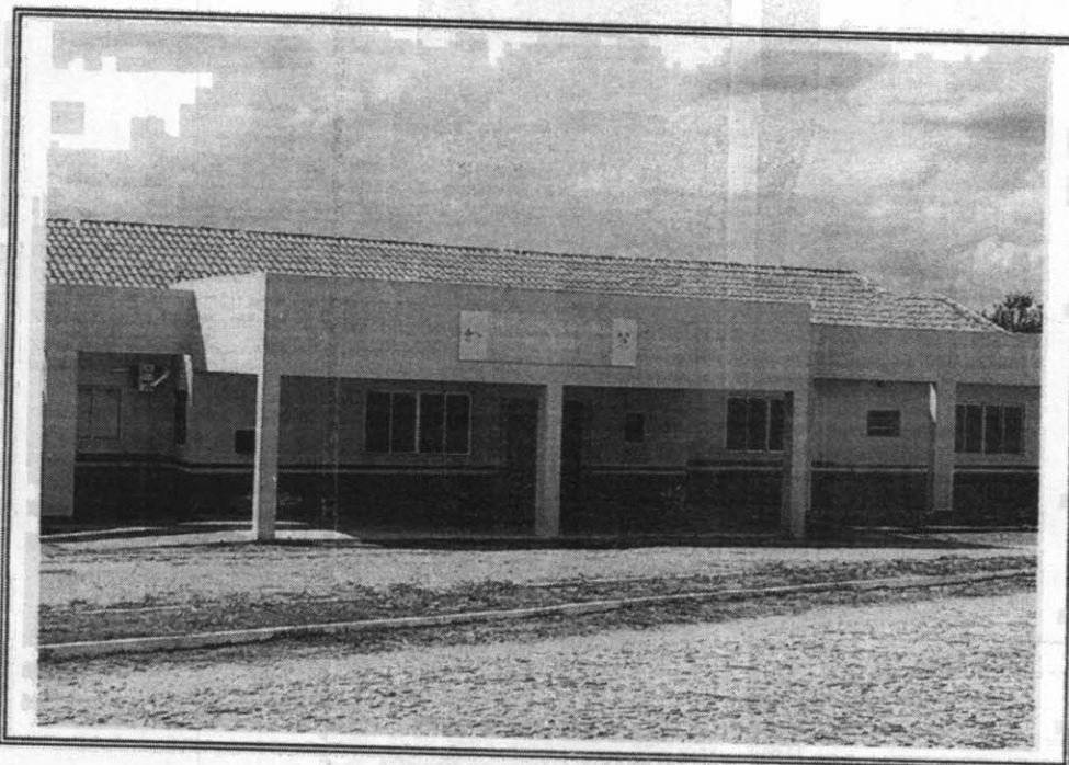
Foto 10 - Portas e pintura danificada-ALMAS
