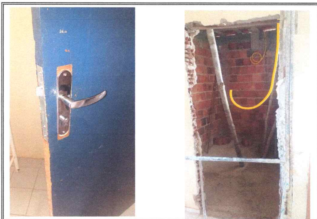
Foto 18 -Porta e Reboco com defeito-JURE
