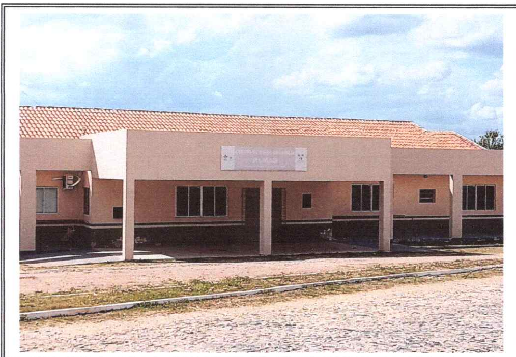
Foto 10 - Portas e pintura danificada-ALMAS
