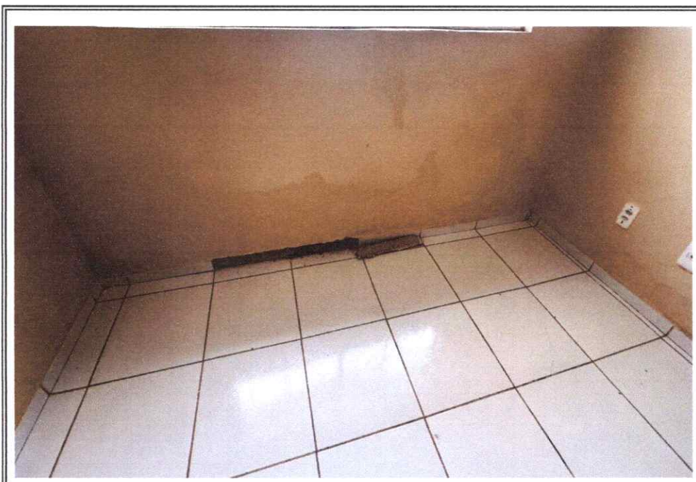
Foto 08: Reboco com defeito-ALMAS
