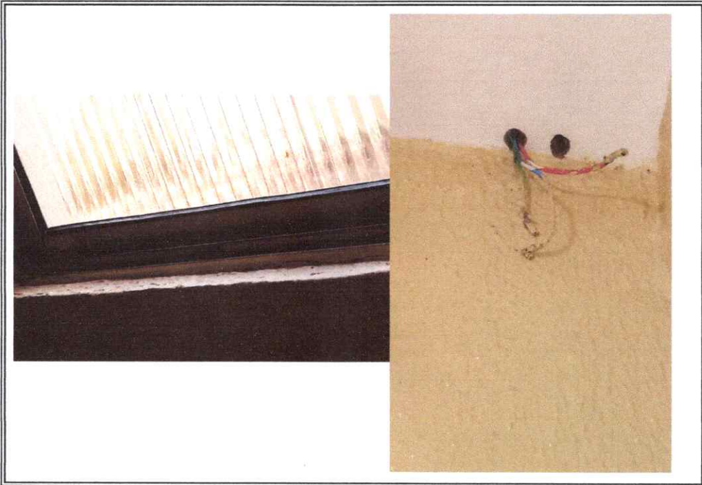
Foto 11 - Janela quebrada e instalacao com defeito-ALTO DOS HONORIOS
