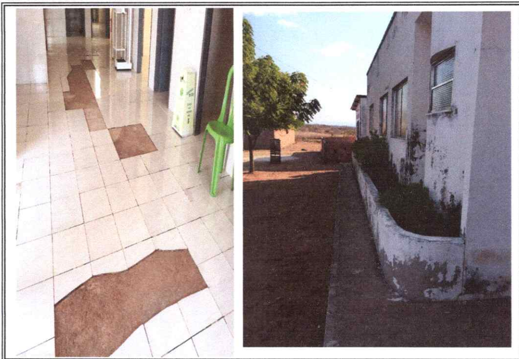
Foto 21-Piso e pintura danificada-SERROTE BRANCO
