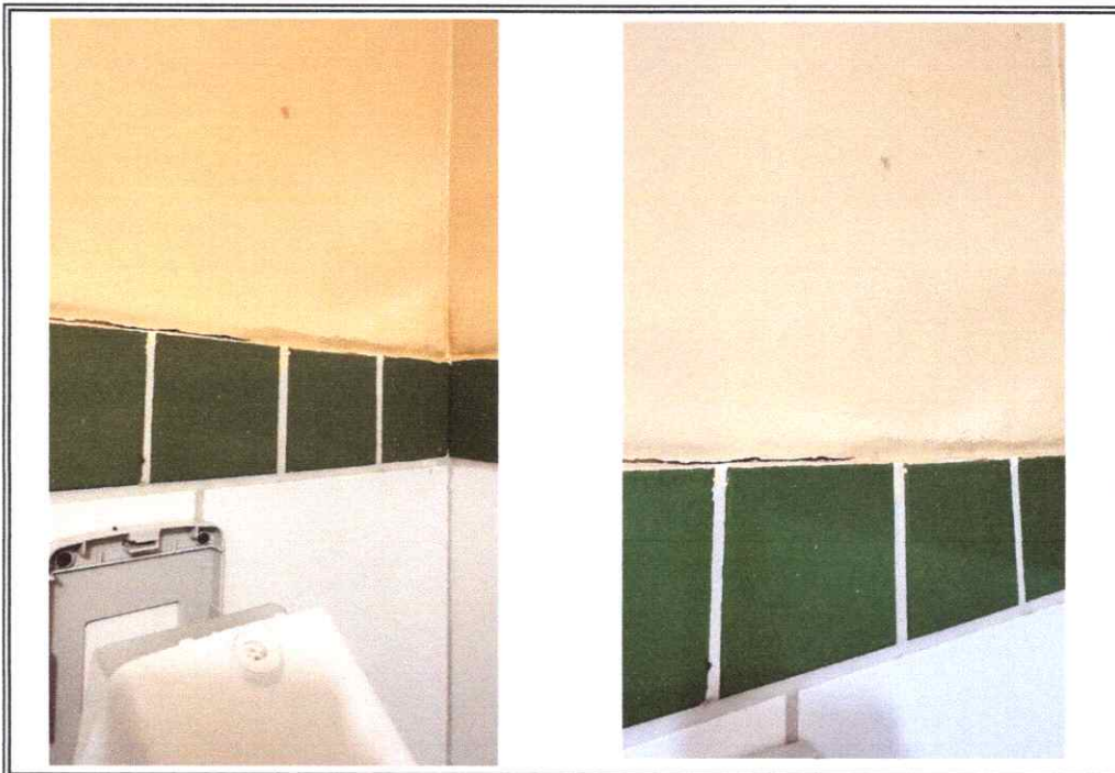
Foto 07 - WC com ceramica e reboco danificado-ALMAS
