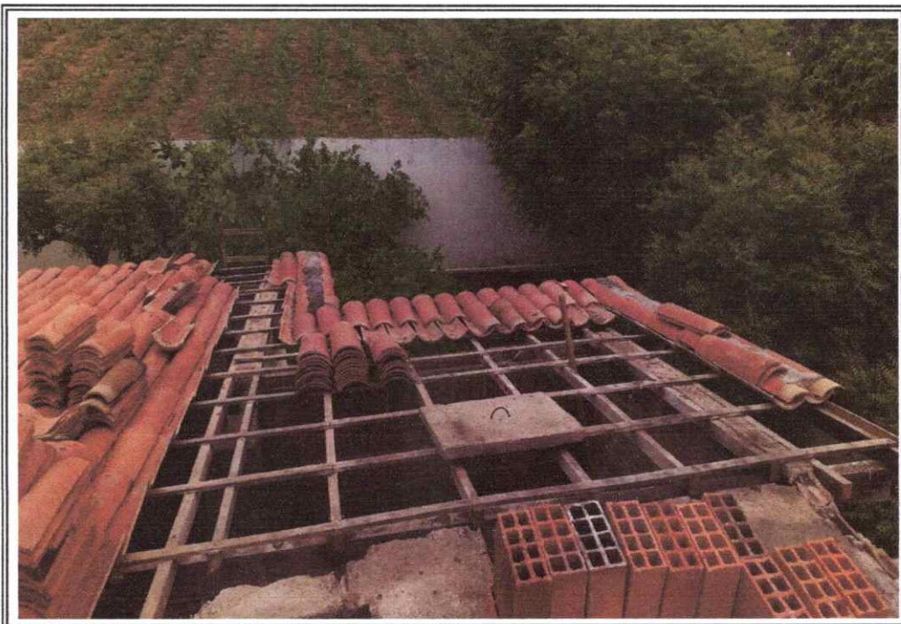
Foto 20: Telhado danificado-BOA ESPERANCA
