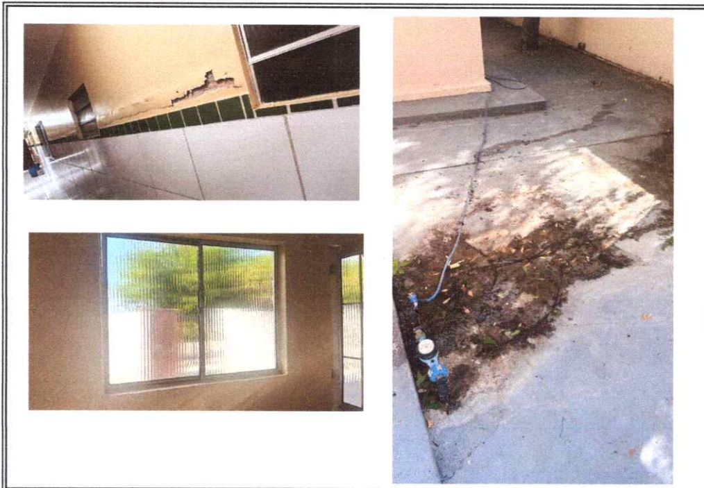
Foto 09 - Janela com vidro quebrado, reboco danificado-ALMAS
