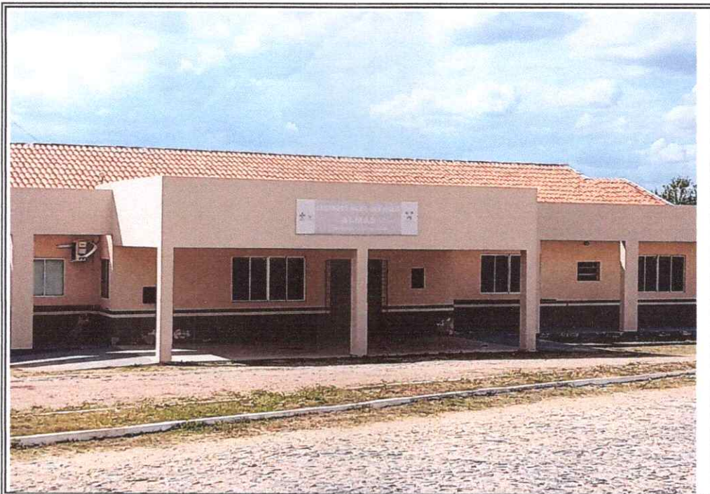
Foto 25 - Telhado e pintura danificada-ALMAS
