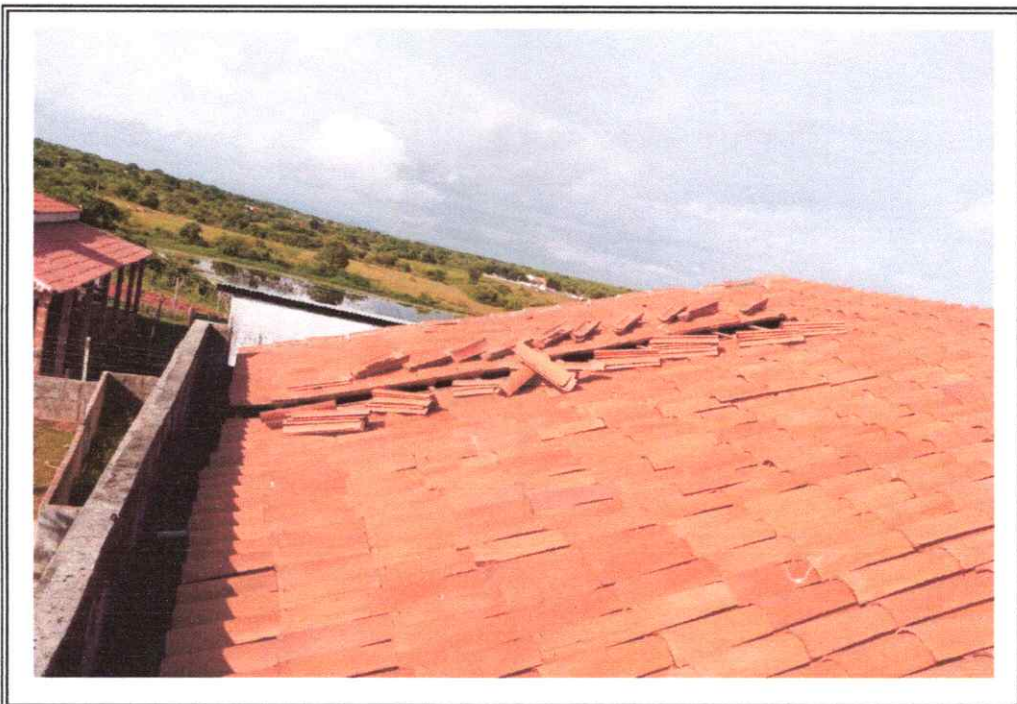
Foto 16 - Telhado danificado JURE
