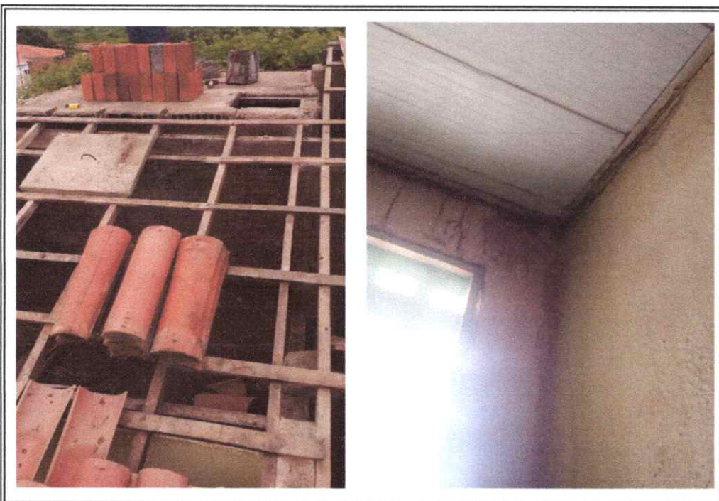
Foto 26 - Telhado danificado -CACIMBAS
