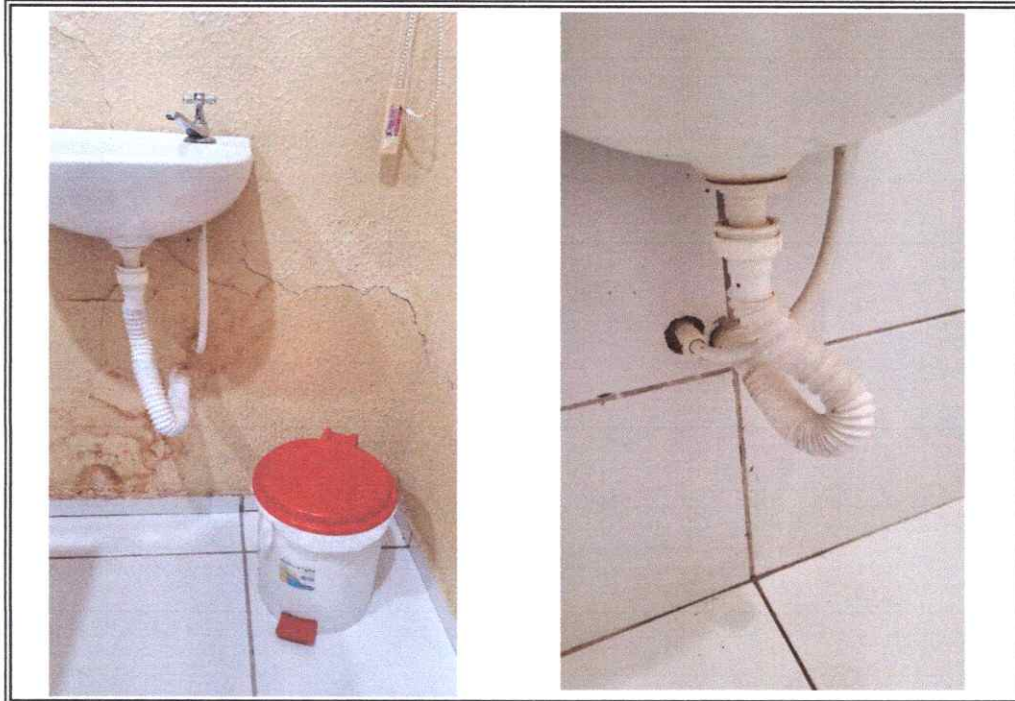
Foto 03 -Instalacao hidraulica com defeito-ALTO FELIZ
