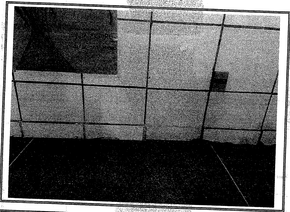
Foto 10- Vista das paredes com revestimento danificado
