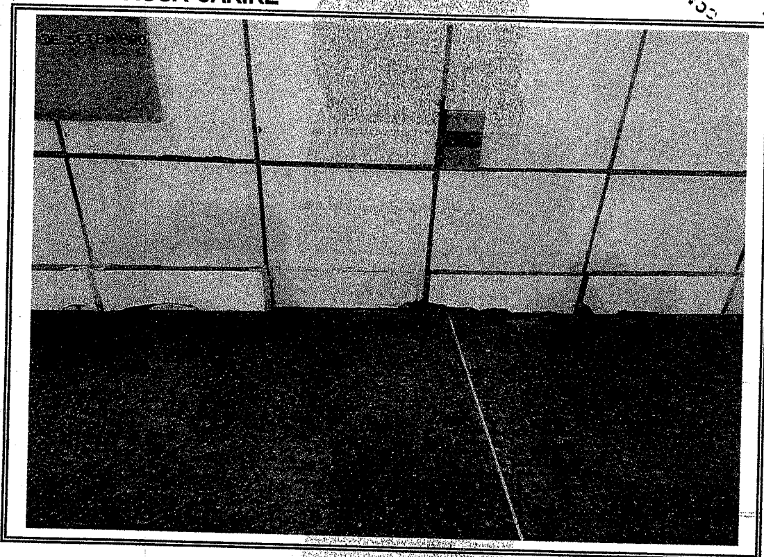
Foto 07 - Piso danificado e cerâmica revestimento danificado
